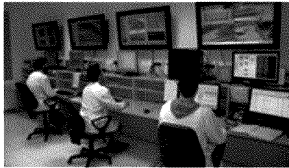
La sala controllo di Esapro
